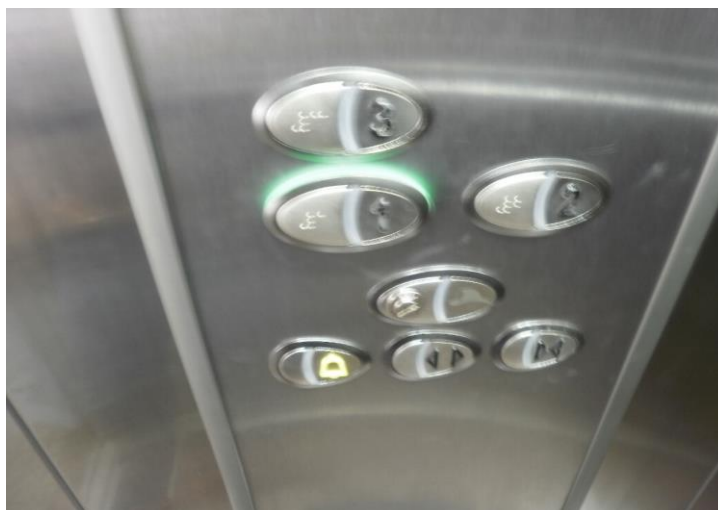
Figura 04: Elevador com botoeiras em braile, conforme Art. 27, 2º Junto às botoeiras externas do elevador, deverá estar sinalizado em braile em qual andar da edificação a pessoa se encontra.
